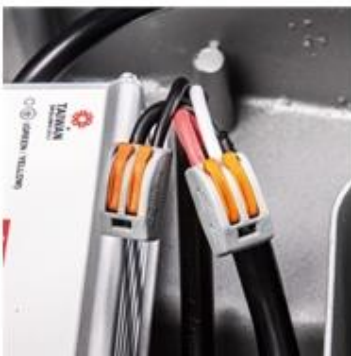
Connecteurs de type WAGO en sortie.
